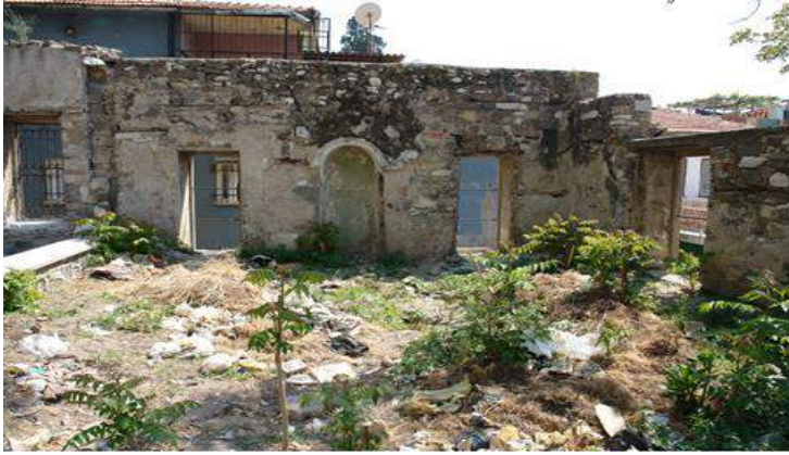
Zâviyenin Restorasyon Öncesi Genel Görünümü
