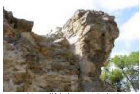
Fotoğraf 8, Kadifekale Mescidi'nin doğu duvarının tonozlu yapıya birleşen dış yüzü.
